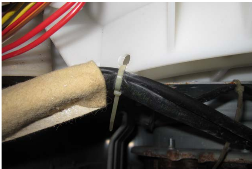
本体内部 [水槽底部のリード線結束部]
